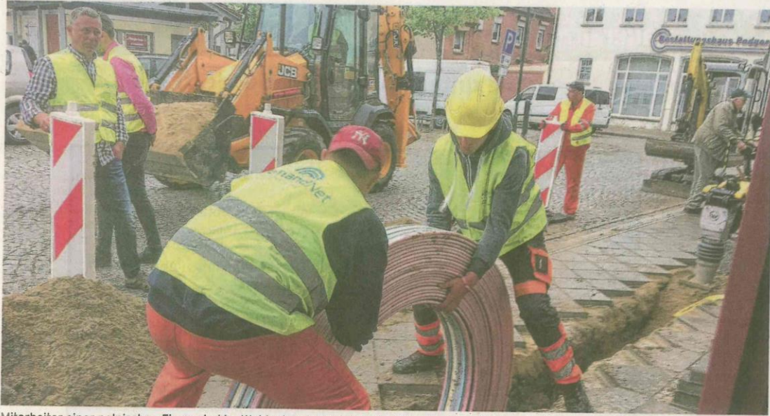
Mitarbeiter einer polnischen Firma sind im Woldegker Amtsbereich im Einsatz, um im Auftrag der Landwerke MV Glasfaserkabel zu verlegen.
